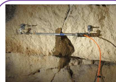
Surveillance par fissuromètre
