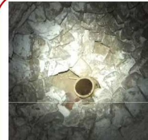
Canalisation artisanale rejetant des eaux usées dans la cavité
